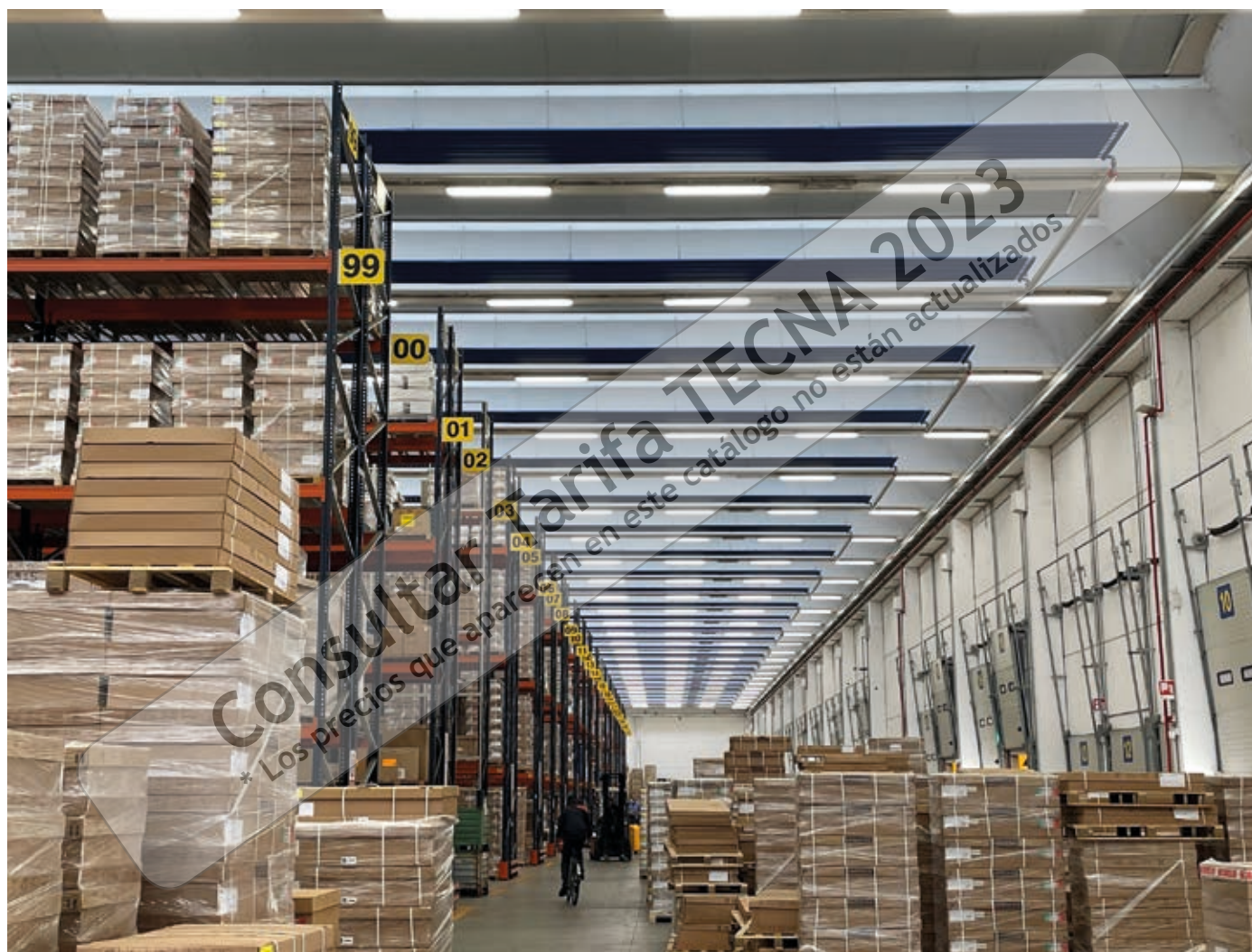
Instalación de calefacción con paneles radiantes SABIANA en el almacén de SABIANA (Italia).
