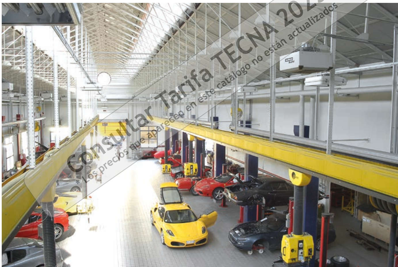
Instalación de desestratificadores TECNA SABIANA NO STRAT en la fábrica de Ferrari, Módena, Italia.
